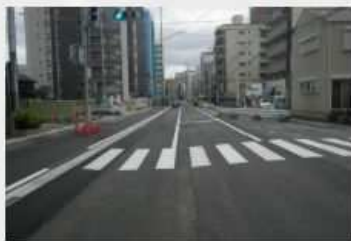
都市計画道路博多箱崎線外1線(千代・馬出)道路舗装工事(その3)
